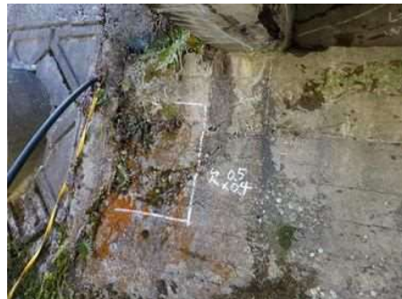
下部工のひび割れ
