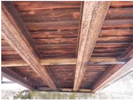
鋼床版の腐食・欠損
