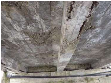
コンクリートのはく離・鉄筋露出・浮き
