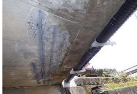
コンクリート床版の鉄筋露出
