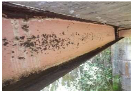
主桁の腐食・防食機能の劣化
