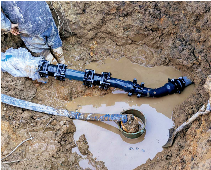
老朽化により漏水した水道管（井関地区）
