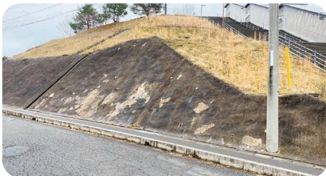
法面保護の改修が必要な三和小学校通学路
